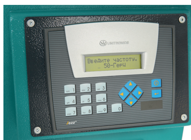
Панель управления Смесителя турбулентного С 2.0
